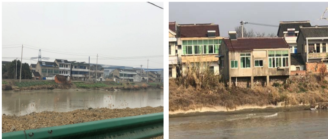
图 4-1 中河岸坡沿岸受船行波冲刷影响
