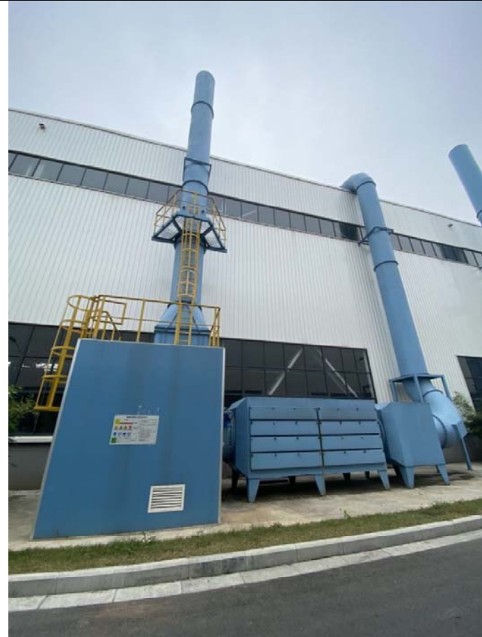
袋式除尘+二级活性炭吸附（浇注废气治理设施）
