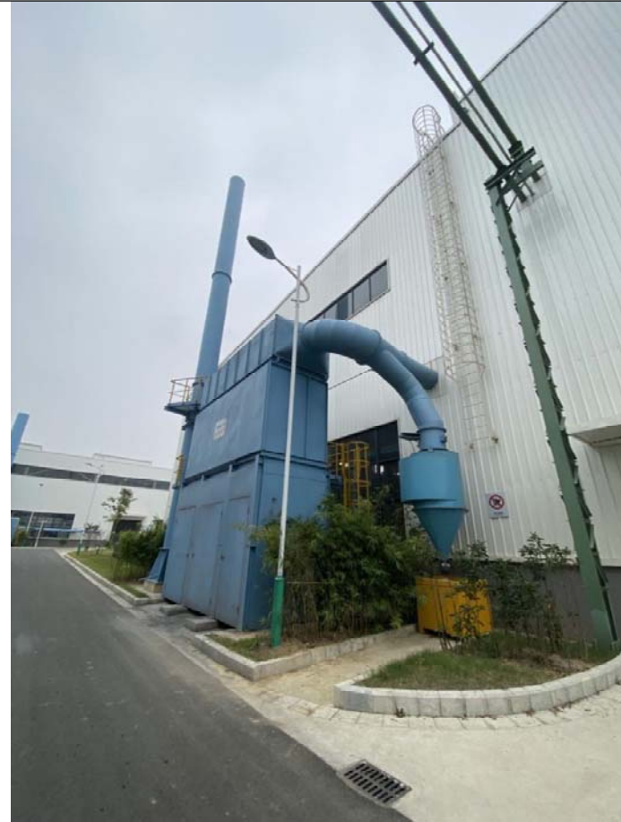
旋风+袋式除尘器（抛丸废气治理设施）
