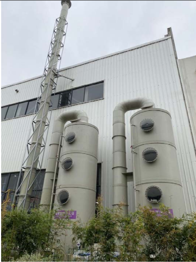
水洗+碱洗塔（酸洗废气治理设施）
