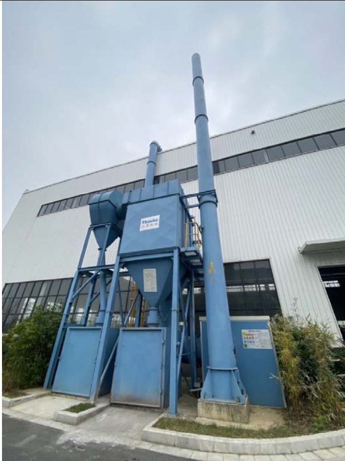
袋式除尘器（熔化废气治理设施）
