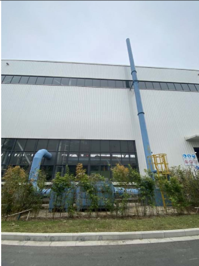
初效过滤+二级活性炭吸附（制芯废气治理设施）
