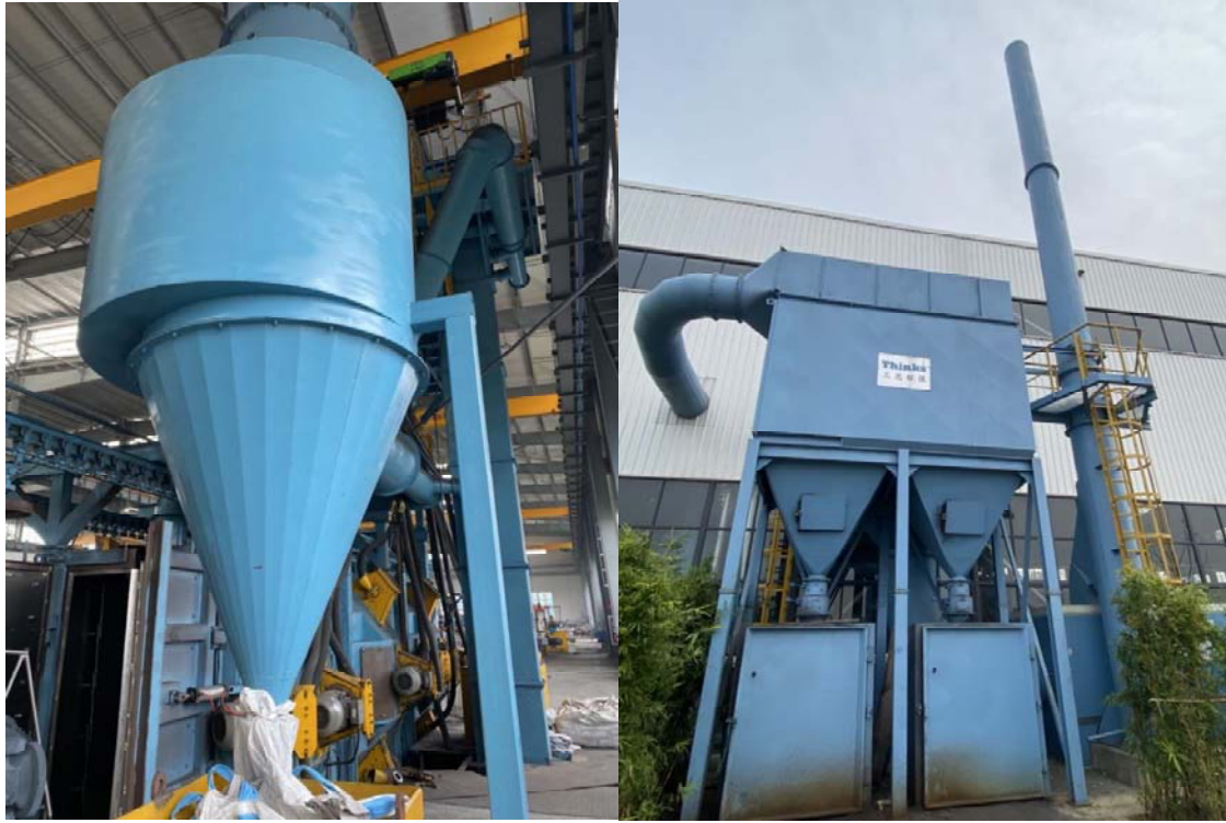
旋风除尘+布袋除尘（抛丸废气治理设施）
