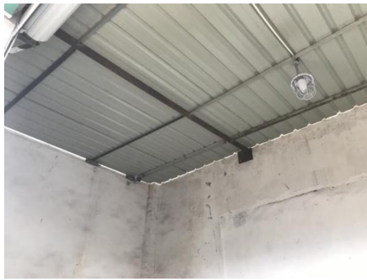
照片 7-防爆灯、内部视频监控
