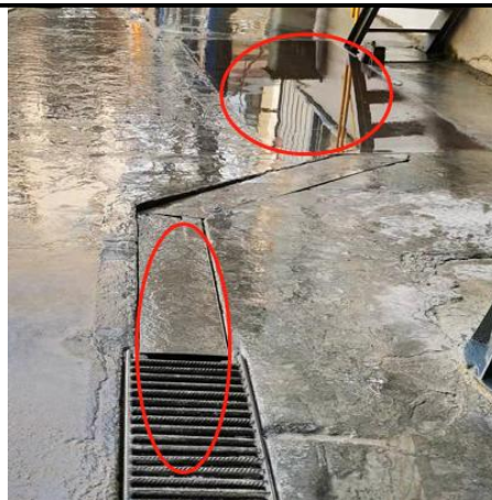
场地清洗废水收集沟及沉淀池
