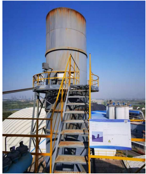
35m 高排气筒
