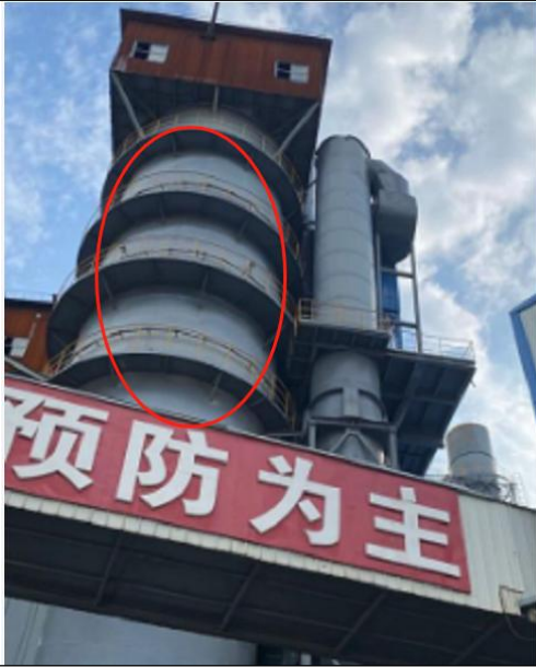
CFB 循环流化床脱硫脱硝装置
