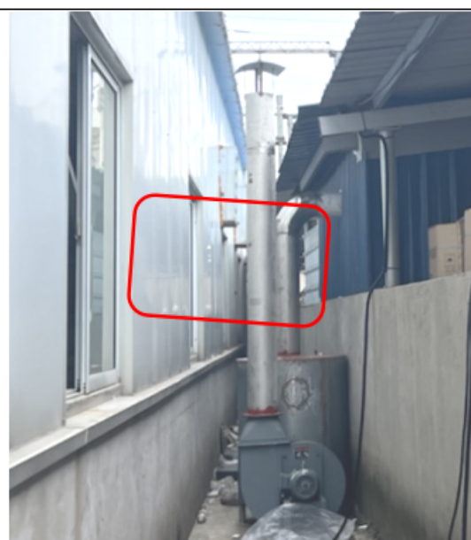
库房内设置气体导出及净化装置
