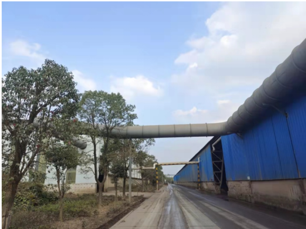
图 2-6 堆棚负压废气收集管道
