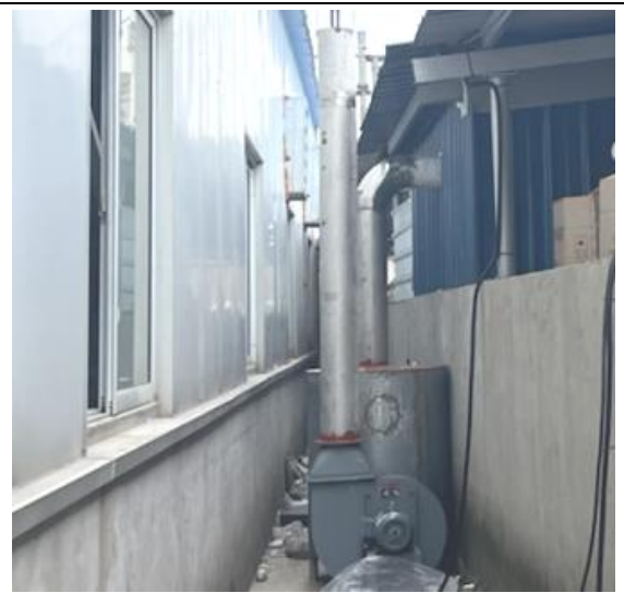
库房内设置气体导出及净化装置
